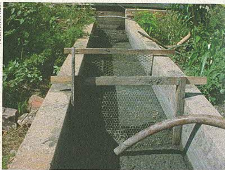
Figura 18. Conjunto de telas utilizadas para separação de sólidos grosseiros em uma unidade de produção de suínos.
