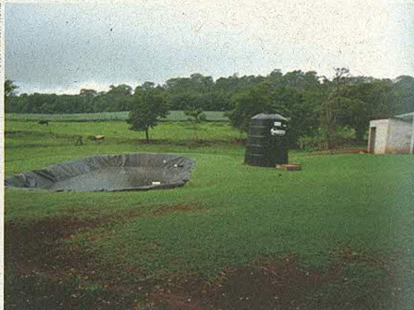
Figura 10. Variação de modelo Upstream Anaerobic Sludge Blanket (UASB) utilizado em Marechal Cândido Rondon, PR. O tanque à direita da foto representa o biodigestor para tratamento de efluentes da bovinocultura. A lagoa à esquerda representa o tanque para armazenamento de biofertilizante.
