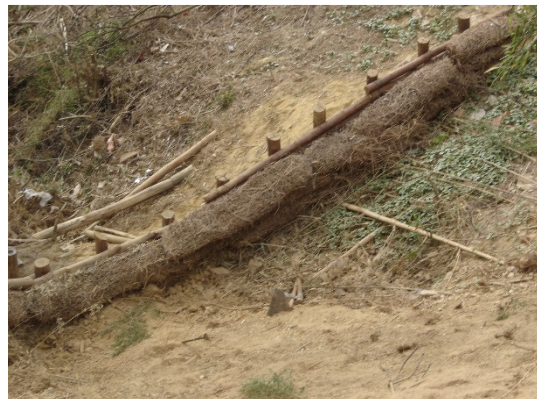
Figura 9: Retentores de sedimentos.
