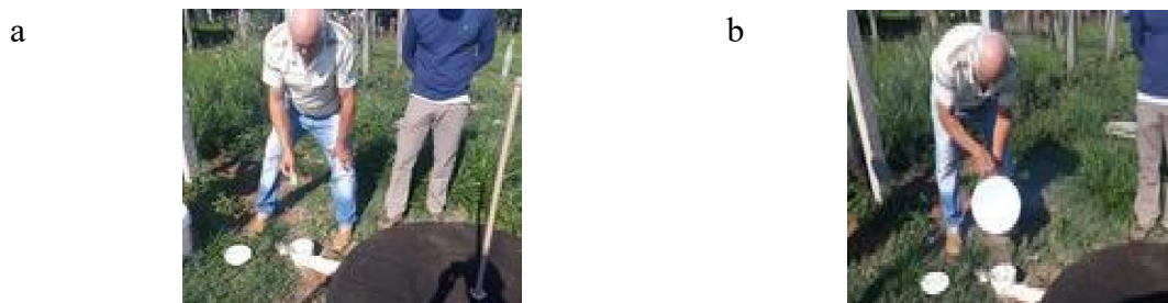
Figura 1. Imagens da inoculação da Fossa Séptica Biodigestora com bioativo comercial. (a) Colocação do sachê com inóculo e (b) adição de água para levar o inóculo ao sistema biodigestor.
