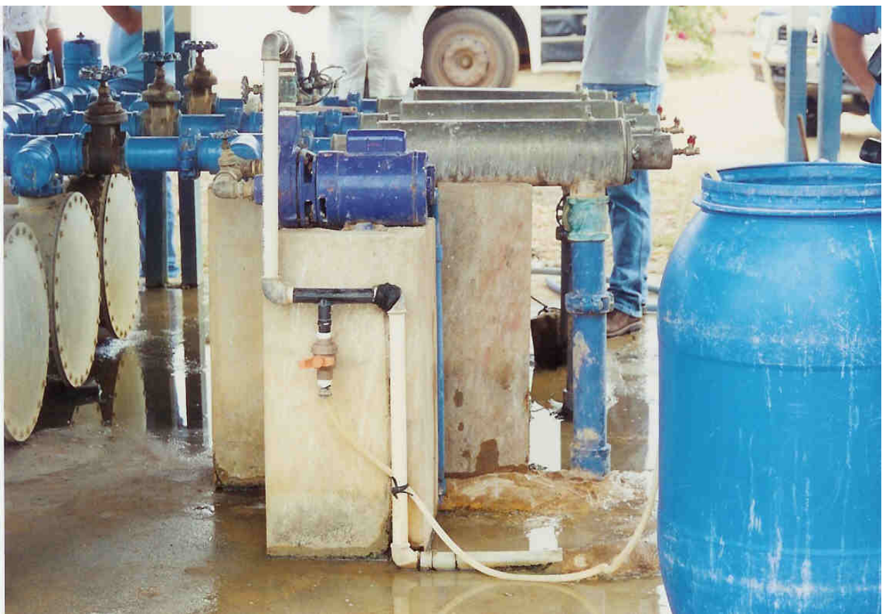
Figura 9 Detalhe de Venturi no cabeçal de controle
