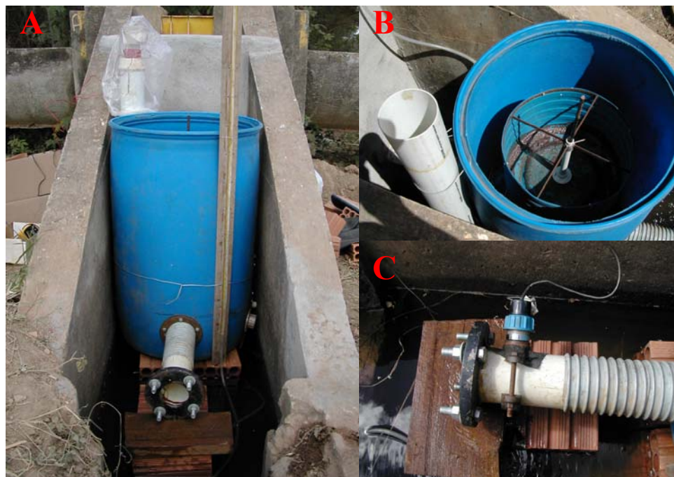
Figura 9. Protótipo 3 instalado em uma tomada d'água do projeto Gorutuba (A), com detalhes do flutuador e poço tranquilizador para medição de nível (B) e sensor de vazão na saída do aparato (C). Nova Porteirinha, MG, 2005.
