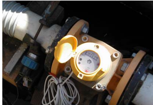
Figura 3. Hidrômetro com turbina tangencial instalado a jusante do sensor eletrônico de vazão.
