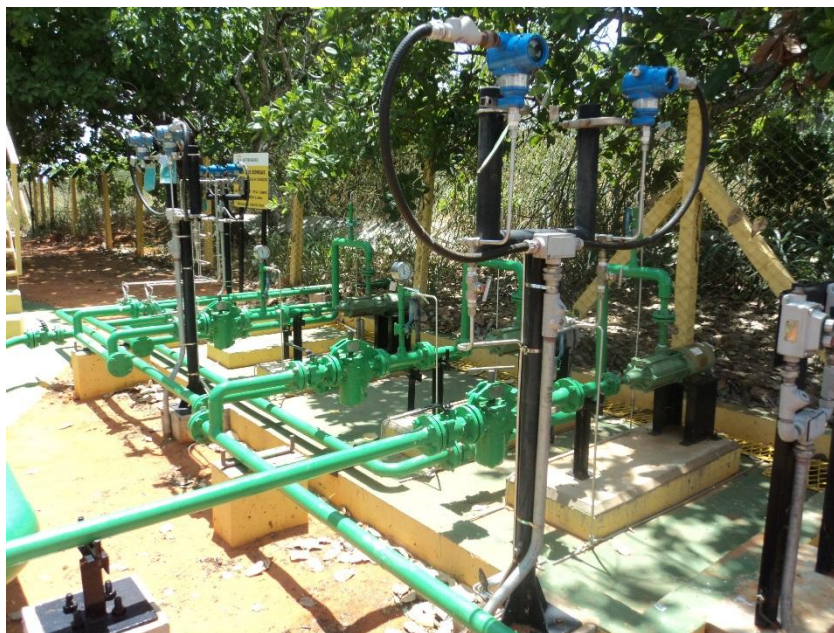
Figura 8 - Diferentes tubulações para distribuição da água produzida filtrada (APF), água produzida tratada por osmose reversa (APO) e água captada do aquífero (ACA).
