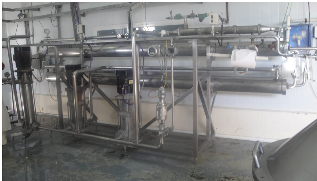
Figura 3.6 Equipo de nanofiltración en una planta de sueros
