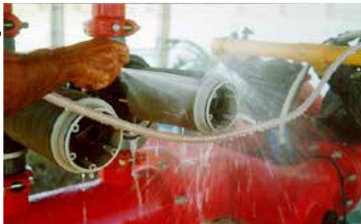
Figura 3. Lavagem manual dos elementos filtrantes de um sistema de filtragem de água de irrigação localizada.
