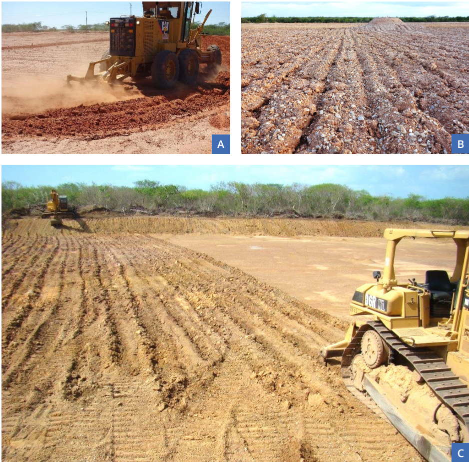
Figura 3. (A) Subsolação de área de central de depósito de resíduos utilizando subsolador com hastes de 50 cm. (B) Vista após a subsolação. Notar o marco de altura, no ponto central, demonstrando o quanto a cota da paisagem foi reduzida. (C) Subsolação de jazida de piçarra utilizando trator de esteira. Notar ao fundo a retroscavadeira realizando a retificação do talude para a posterior deposição de galharia.
