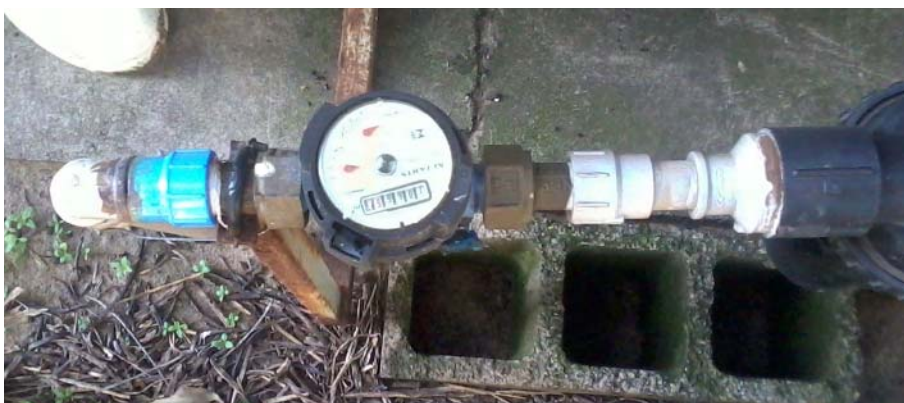
Figura 1. Hidrômetro instalado em um sistema de aves de corte para medição do consumo de água no galpão.
