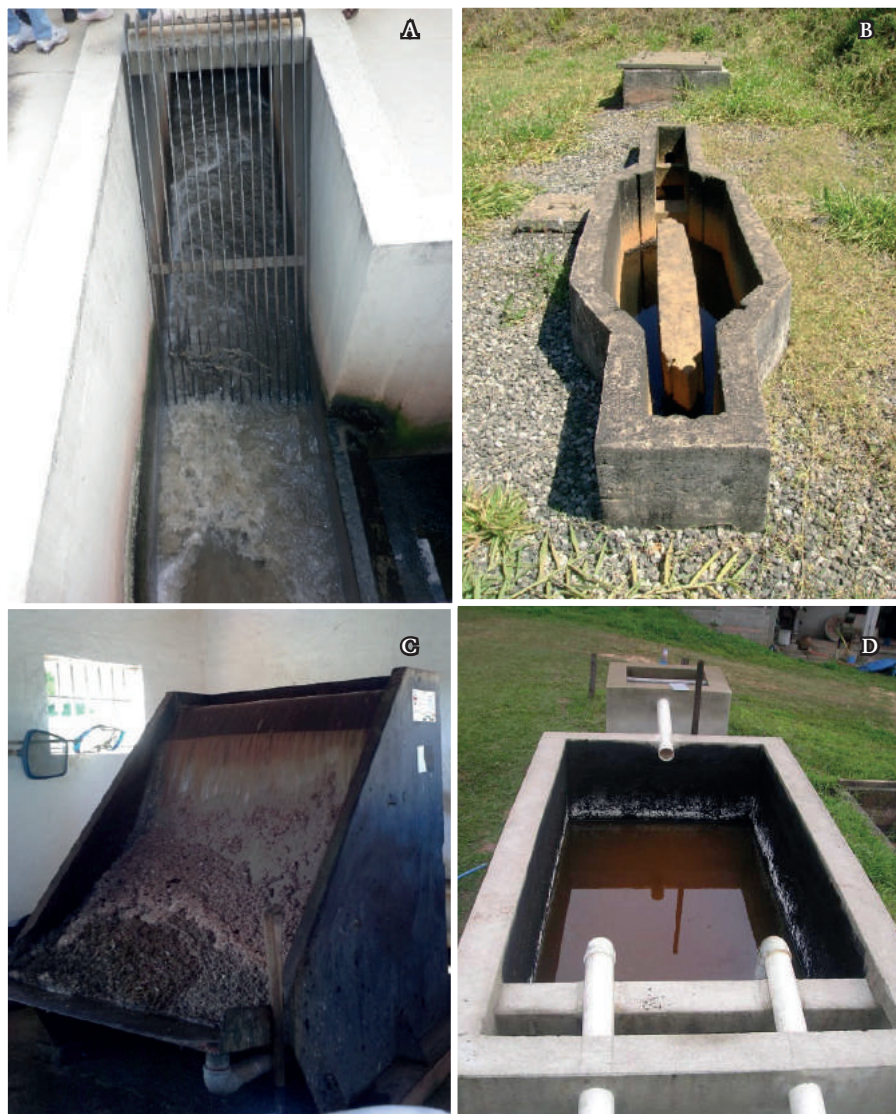
Figura 6. Diferentes unidades preliminares e primárias de tratamento de águas residuárias: (A) grade utilizada no tratamento de esgoto doméstico, (B) desarenador para remoção de areia de lixiviado de aterro sanitário; (C) peneira utilizada no tratamento de efluentes de abatedouro, e (D) decantador primário para remoção de sólidos de águas residuárias do processamento dos frutos do cafeeiro.
