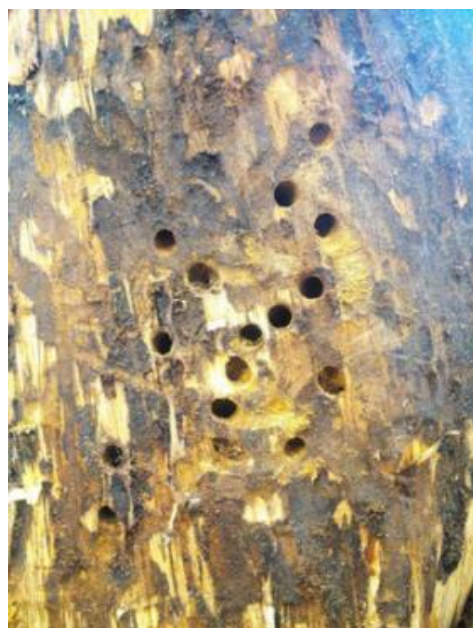
Figura 15 - “Furo de bala” dano Típico do ataque da broca
