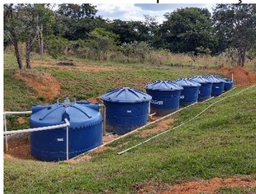
Figura 1 – Imagem do protótipo de sistema descentralizado de tratamento de esgoto sanitário instalado na Embrapa Hortaliças.
