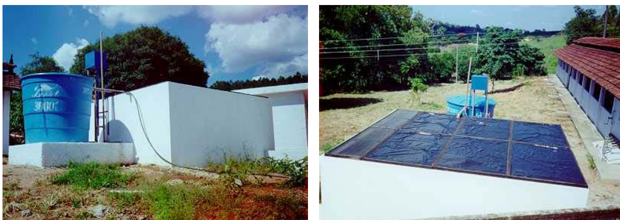
Figura 7. Sistema composto por pré-filtro e filtro lento instalado no Campus do CREUPI, Espírito Santo do Pinhal, SP.
