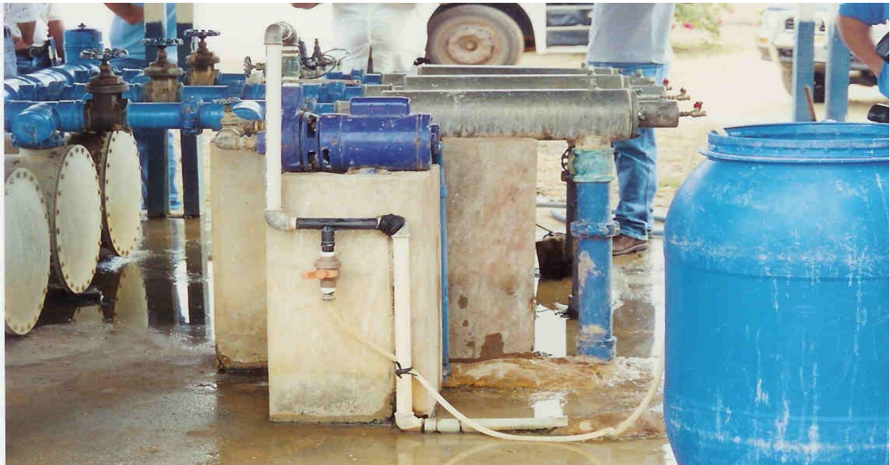
Figura 6 - Detalhe de Venturi no cabeçal de controle (Foto: José Maria Pinto)
